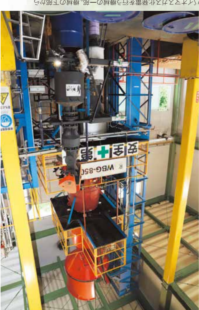
バイオ炭が排出される。発電所の一部。機械の下部から
